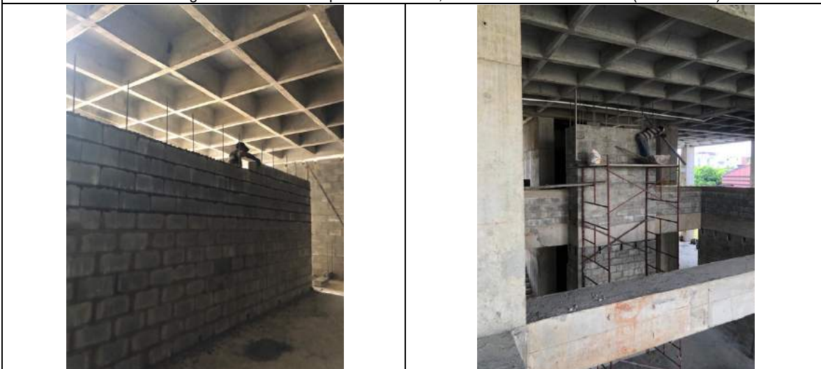
12. Pega de muros con bloque de 14x19x39, zona U.A.R. en semisótano (Nivel – 2.60)
